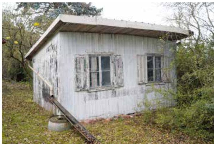
6|38 Behelfsheim aus Steinach a. d. Ens auf einem Gartengrundstück südlich des Nachbardorfs Steinach bei Rothenburg, in den 1960er Jahren hierher versetzt. Im Oktober 2018 wurde es vom Fränkischen Freilandmuseum Bad Windsheim abgebaut. Foto: Markus Rodenberg
